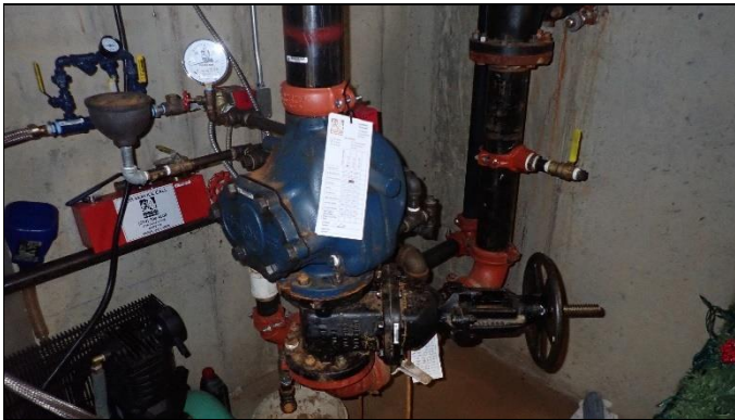
Fire sprinkler riser
