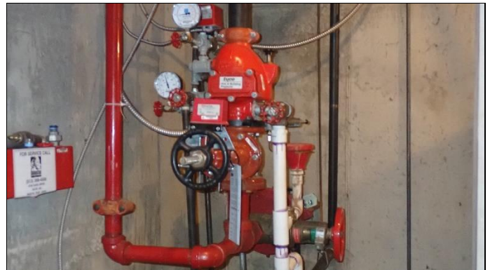
Fire sprinkler riser
