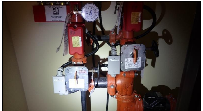
Fire sprinkler riser
