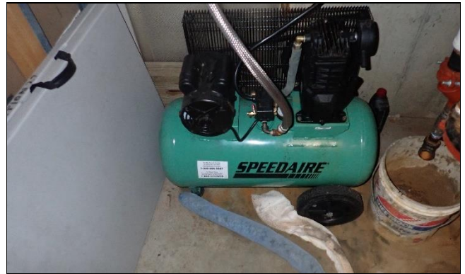
Riser air compressor
