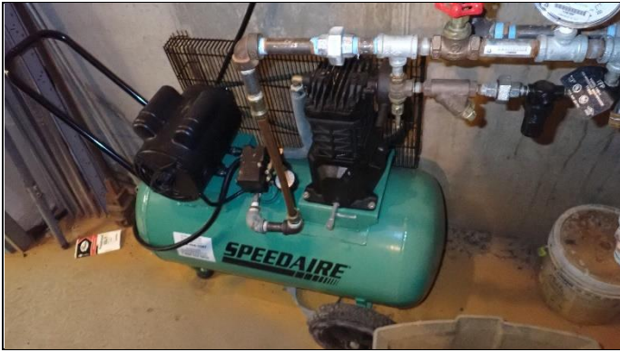
Riser air compressor
